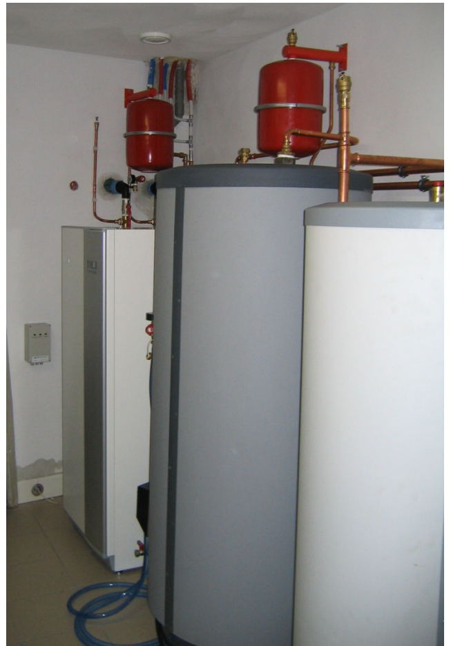
Warmtepompinstallatie in de kelder
