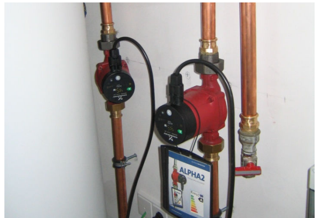
Energie label A circulatiepompen aangestuurd via domotica-systeem
