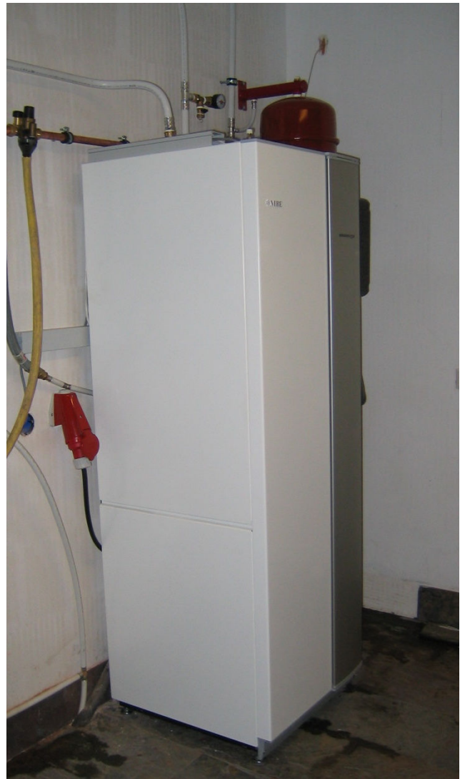
Compacte warmtepompinstallatie in de garage, voor verwarmen, koelen en warm water.
